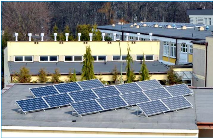
Instalacja fotowoltaiczna - Naruszewicza 18
