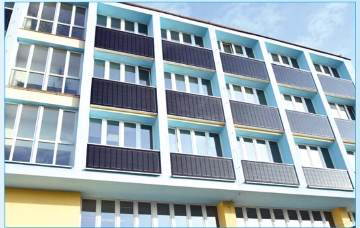
Instalacja fotowoltaiczna - Naruszewicza 18
