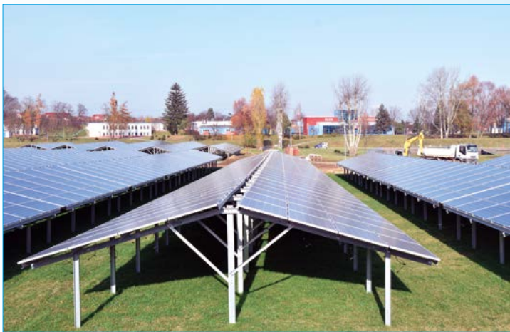
Instalacja fotowoltaiczna w Zakładzie Uzdatniania Wody
