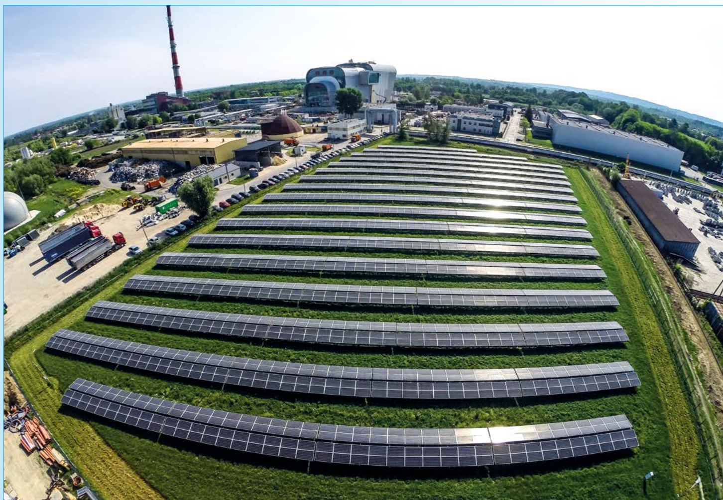
Instalacja fotowoltaiczna na Oczyszczalni Ścieków
